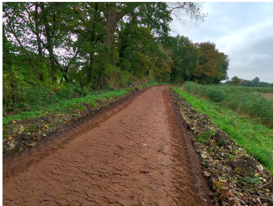
Abbildung F-2: Fahrbahnoberfläche im nicht gekennzeichneten Baustellenbereich, Quelle: Eigene Aufnahme
